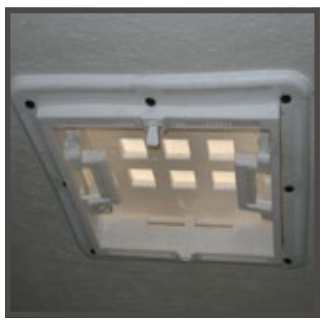
Oblò sul tetto traslucido
